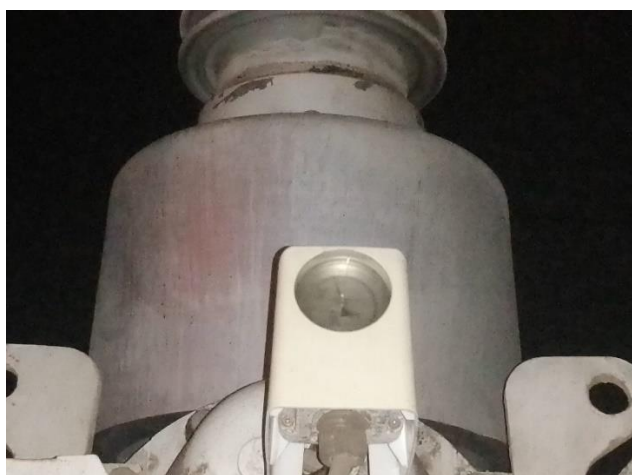
Se rellenó Gas SF6 a 75 PSI
